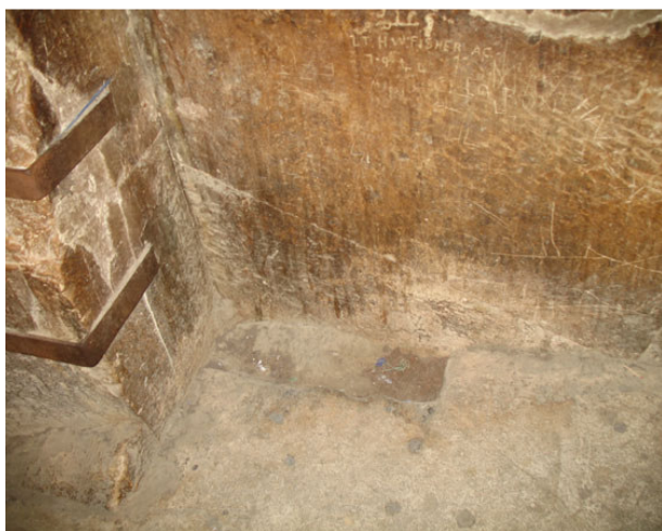
Trous sur le quai
