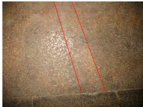
Fissures en partie basse du bloc linteau
