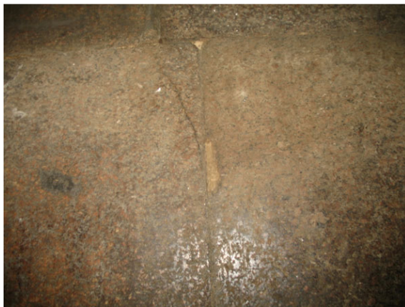
Fissure en partie haute du bloc linteau
