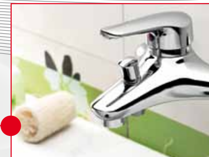
Miscelatore vasca-doccia installato
